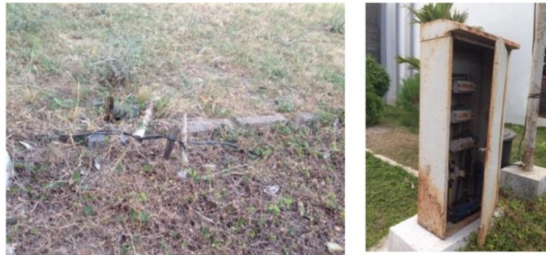
Gambar 4. 2 Kondisi kabel underground di sebuah perumahan skala menengah ke atas 19
