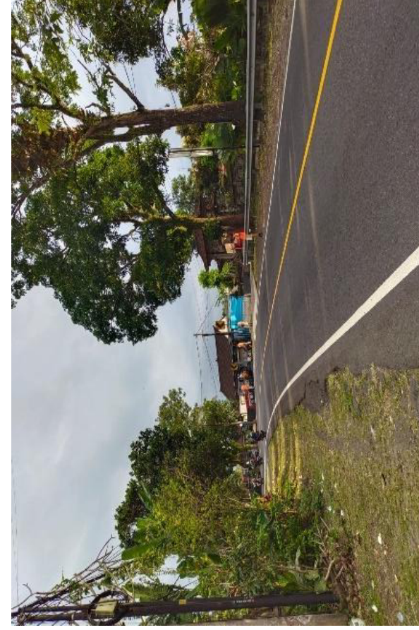
Gambar 3. Kondisi Marka di Ruas Jalan Meliling
